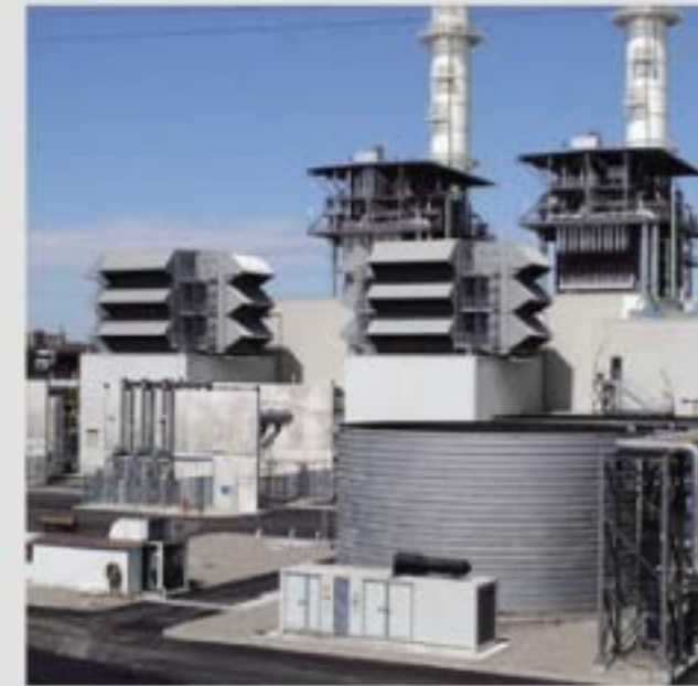
意大利TURBIGO电站 的所有防火系统。 TURBIGO Power Plant, all the fire fighting systems, Italy
